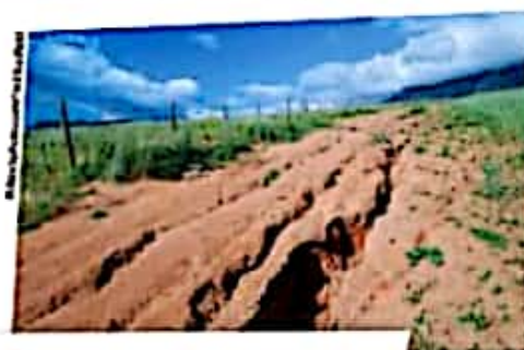
■ Terreno em processo acentuado de erosão
